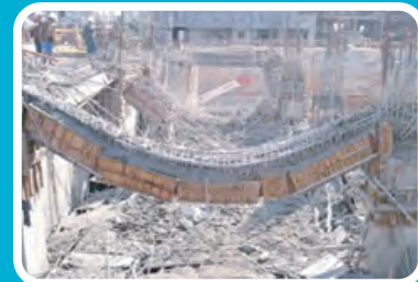
物體倒塌、崩塌
